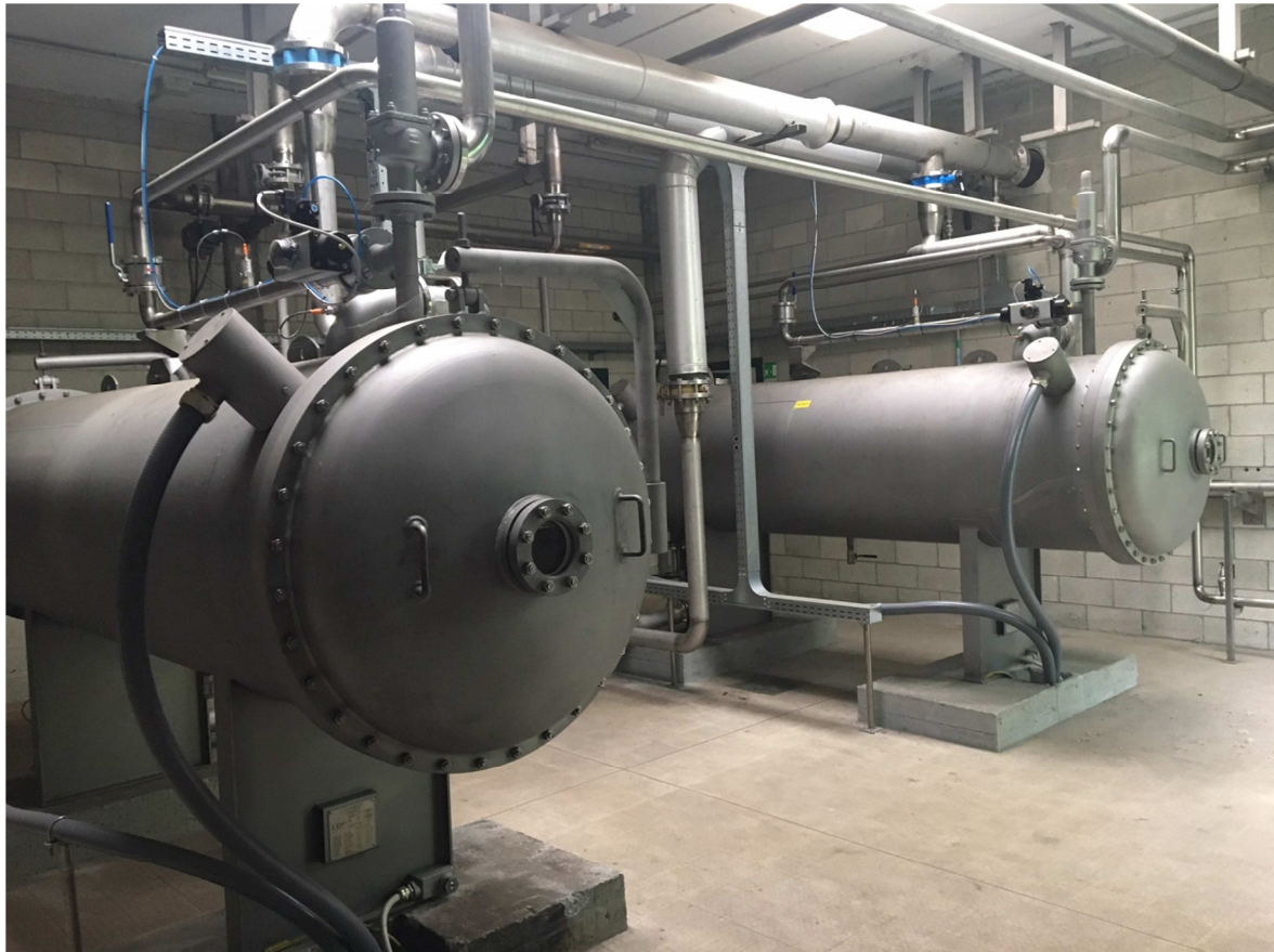
Impianto Alto Seveso – Generatori ozono
